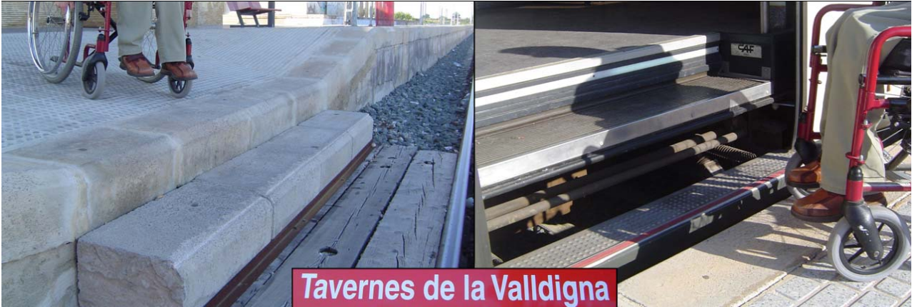
Paso entre andenes impracticable para personas con movilidad reducida.
